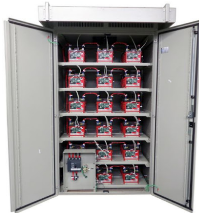
Figura 11 - Banco de baterias
