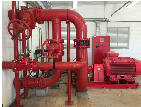
Figura 4 - Bombas hidráulicas para incêndio
